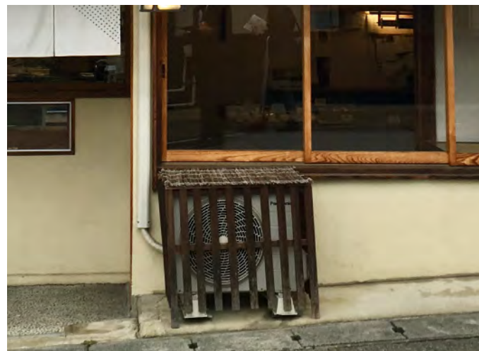
通りに面して置かれた空調などの設備は案外よく目立つため、木ルーバーと呼ばれる格子で目隠した好例。
